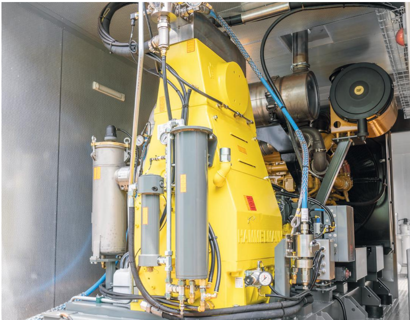
Unità diesel stazionaria in un container insonorizzato
